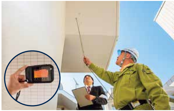
建物診断の様子。目視だけでなく、建築物・外壁診断サーモグラフィを使い、赤外線で外壁のクラックや浮きを確認する
